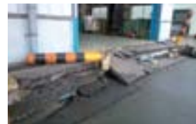
液状化による地盤沈下
