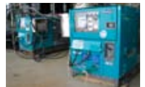
松阪工場提供の発電機(2基)
