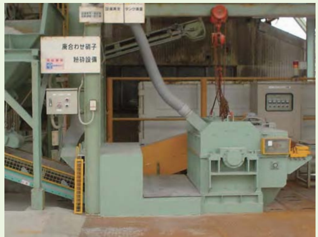
廃ガラスの回収・リサイクルのための設備(松阪工場)
